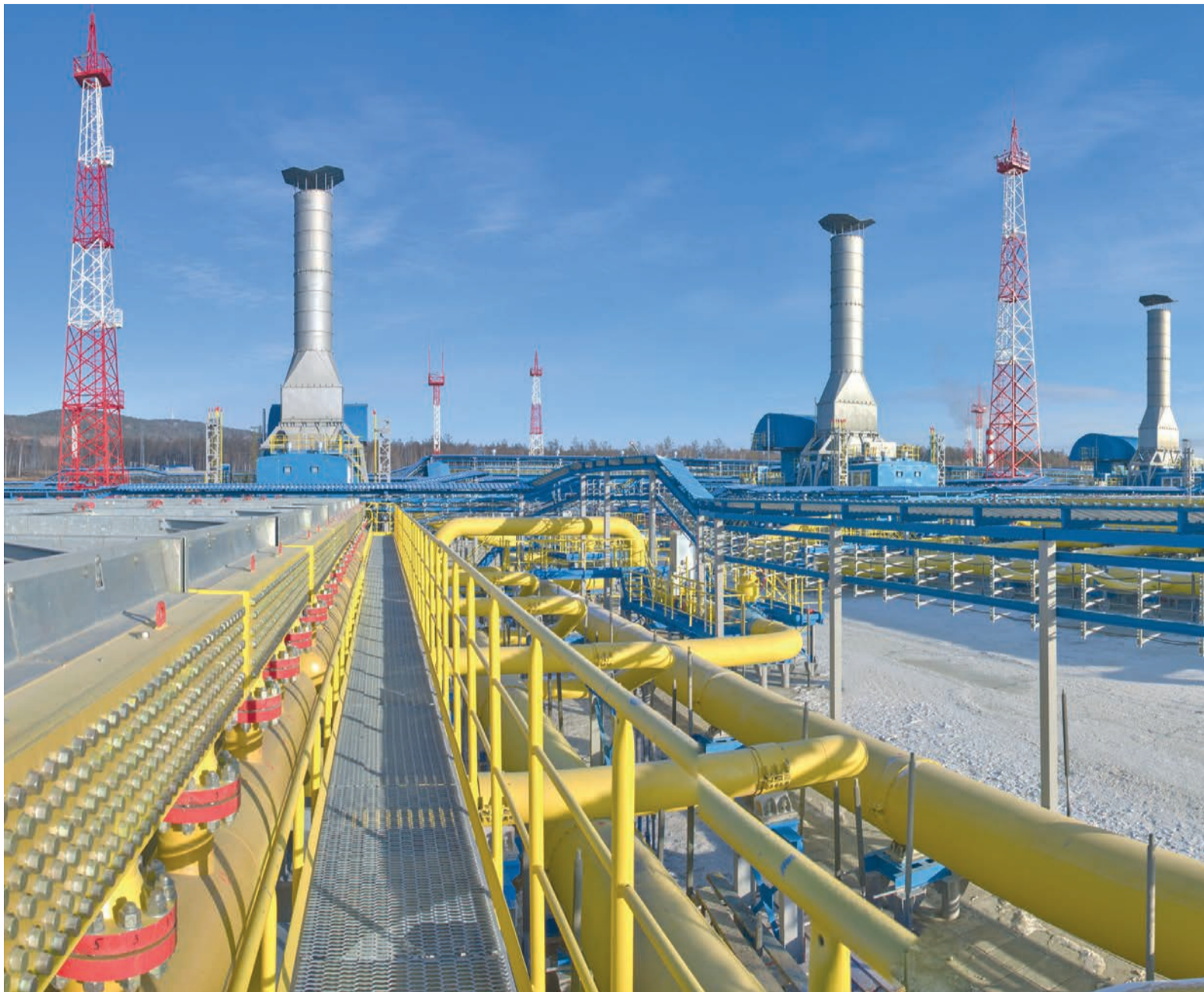
Компрессорная станция «Ерофей Хабаров», магистральный газопровод «Сила Сибири», Сковородинское ЛПУМГ
