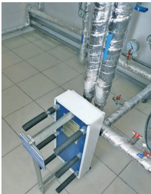
Установленные защитные кожухи на пластинчатые разборные теплообменники системы горячего водоснабжения зданий КС «Проскоково»
